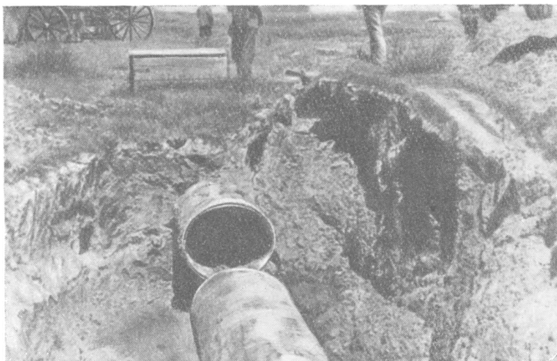
Фиг. 34. Тридцатидюймовая водопроводная труба, разорванная разломом. Район северо-западнее озера Сан-Андреас (Earthquake Investigation Commission, 1908—1910)
